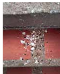
Heces de paloma en el pasillo del segundo piso
