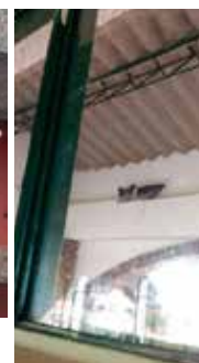
Palomas en viga del segundo piso
